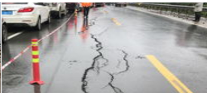
图2 市政道路路面裂缝示意图
