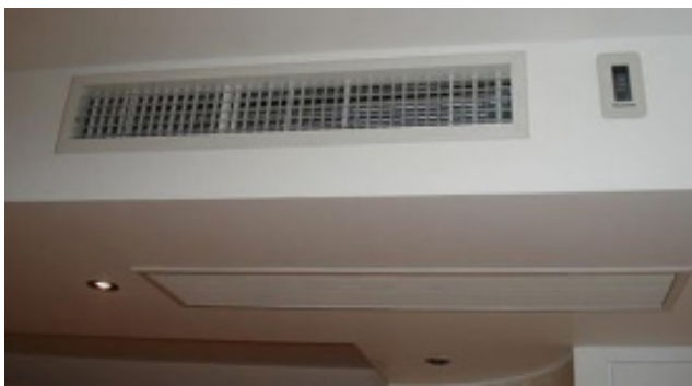
图1 智能建筑暖通空调
