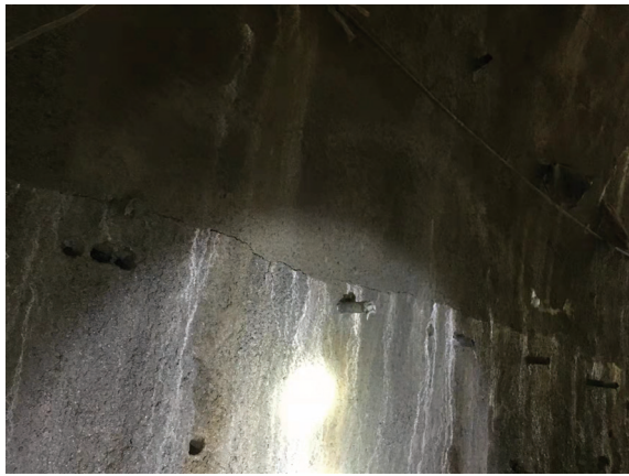
图6 隧道浅埋偏压段拱腰纵向裂缝
